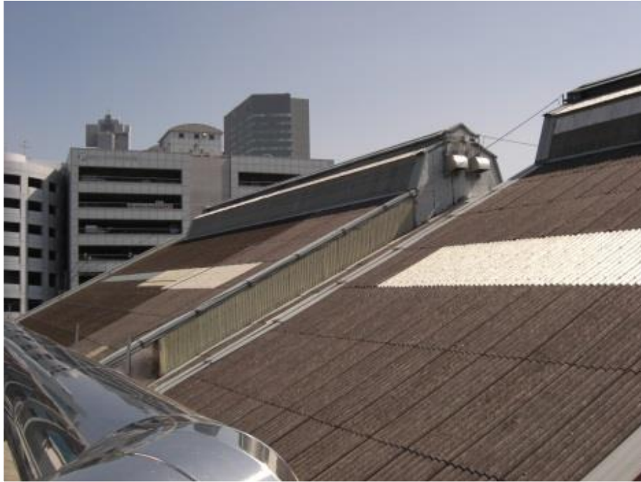
↑ 水産物部仲卸売場 アスベスト含有屋根
