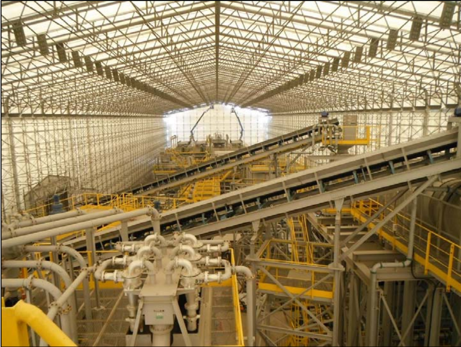
新・洗浄処理プラント内部
