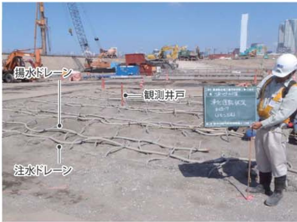
真空ドレーン運転状況
