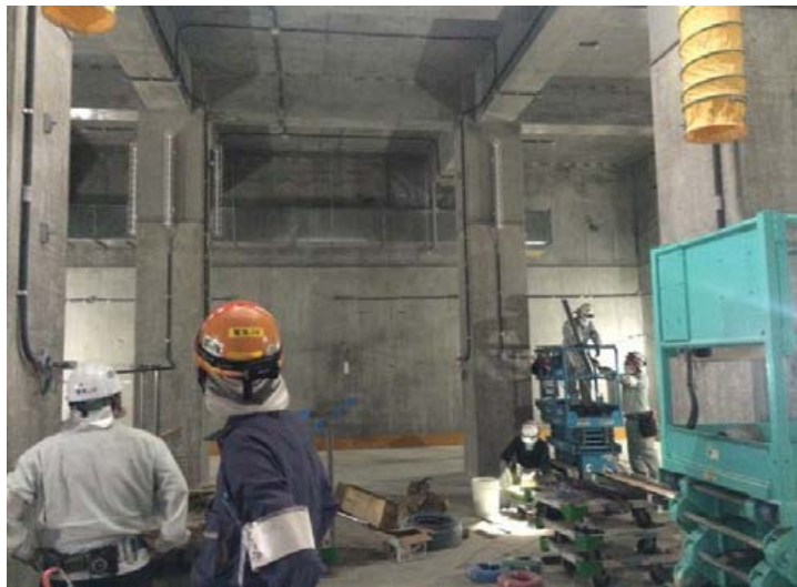
排水施設棟（内部）
