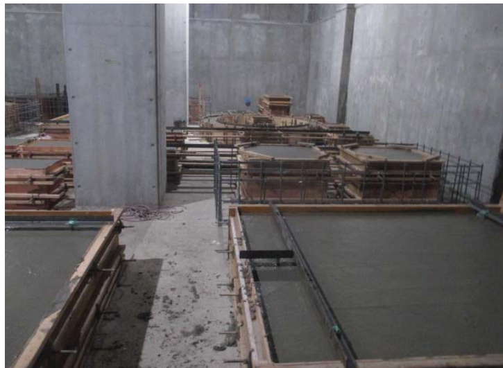
排水施設棟（内部）
