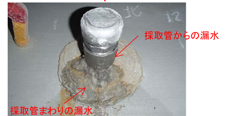
採取管拡大図 (マンホール③)
