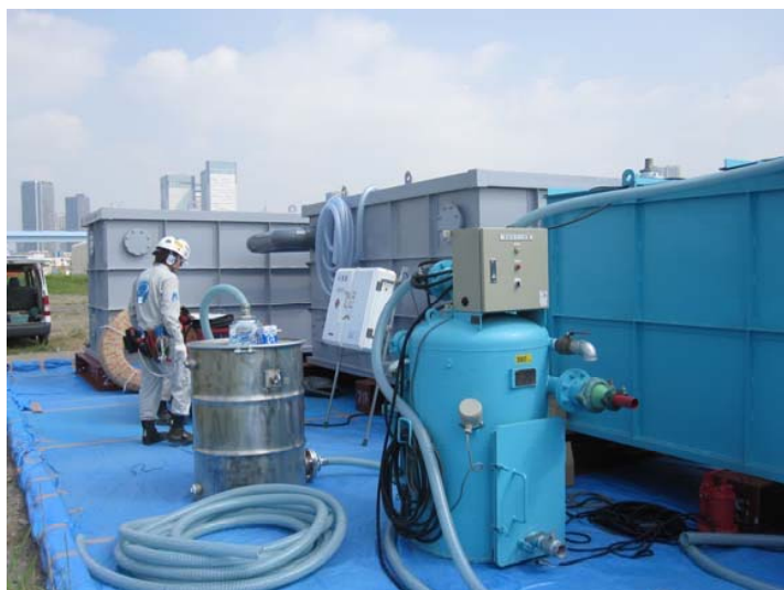
写真-5.2 活性炭吸着装置
