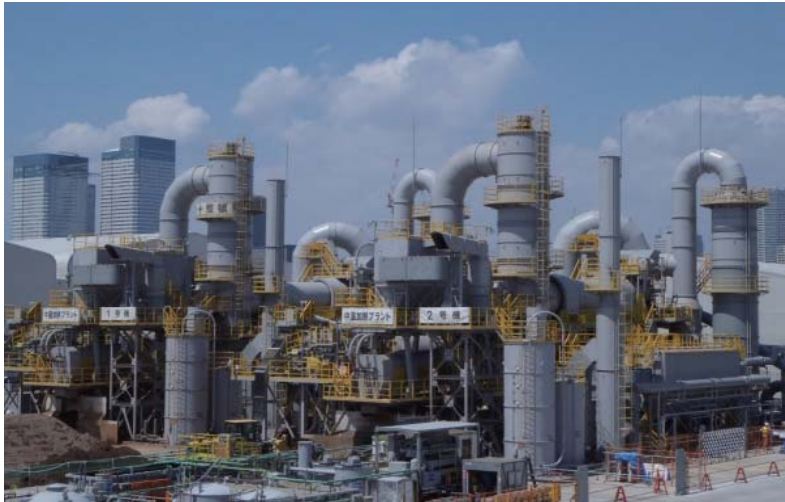
中温加熱処理プラント全景
