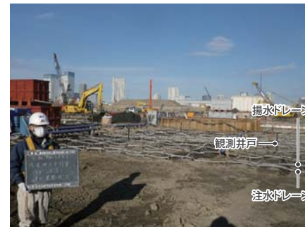
真空ドレーン運転状況
