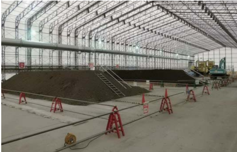
掘削微生物処理プラント全景
