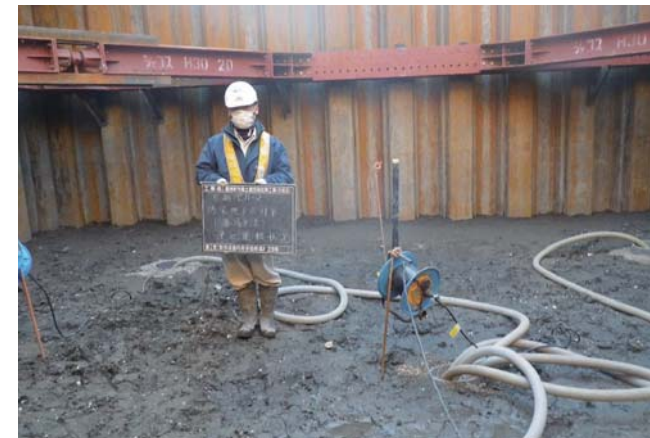
釜場運転状況
