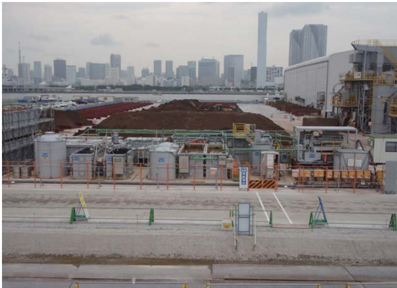
地下水処理プラント設置全景
