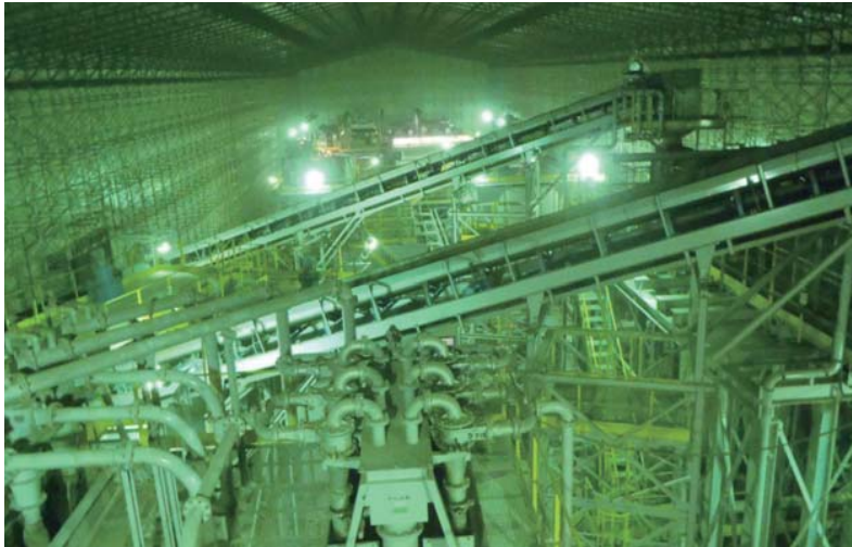
洗浄処理プラント全景
