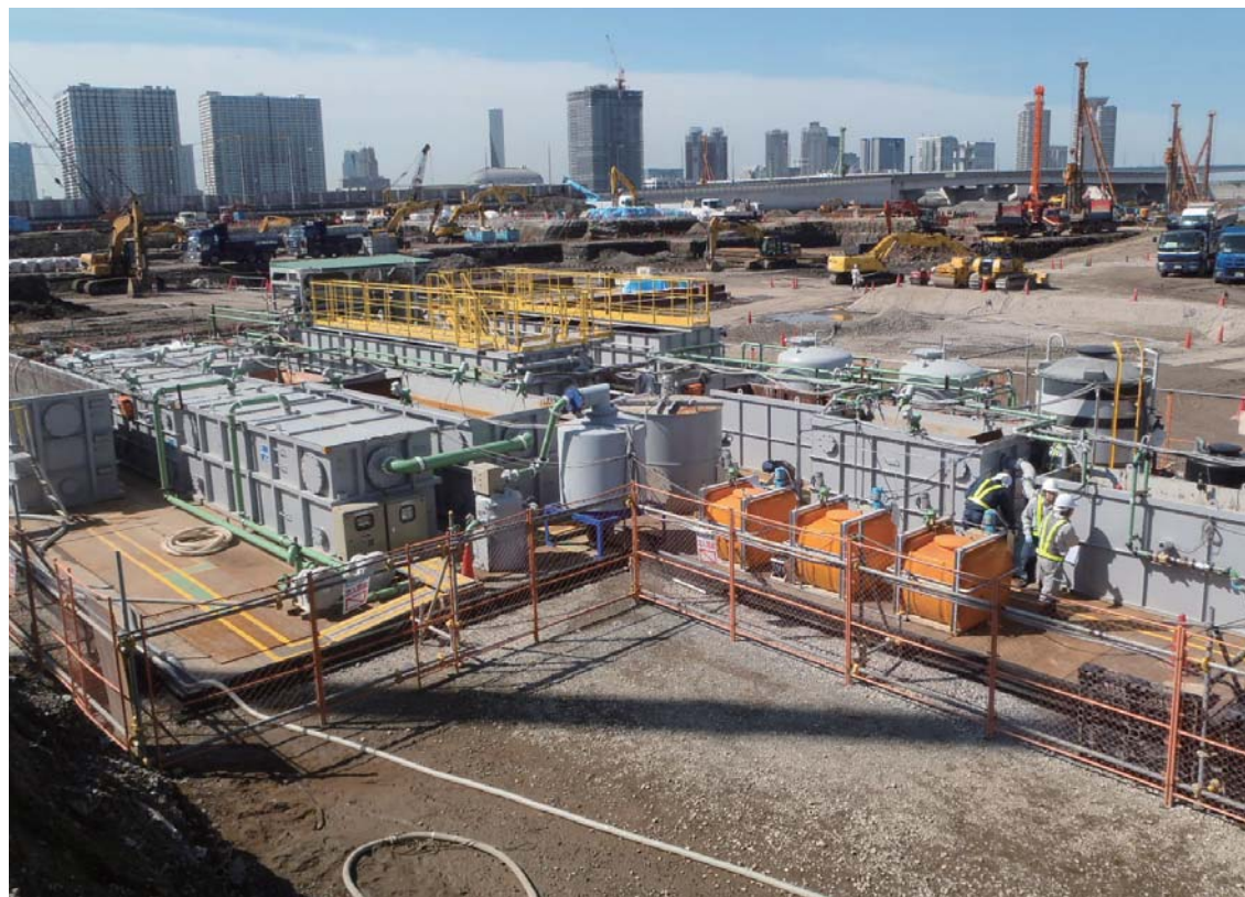
地下水処理プラント設置全景
