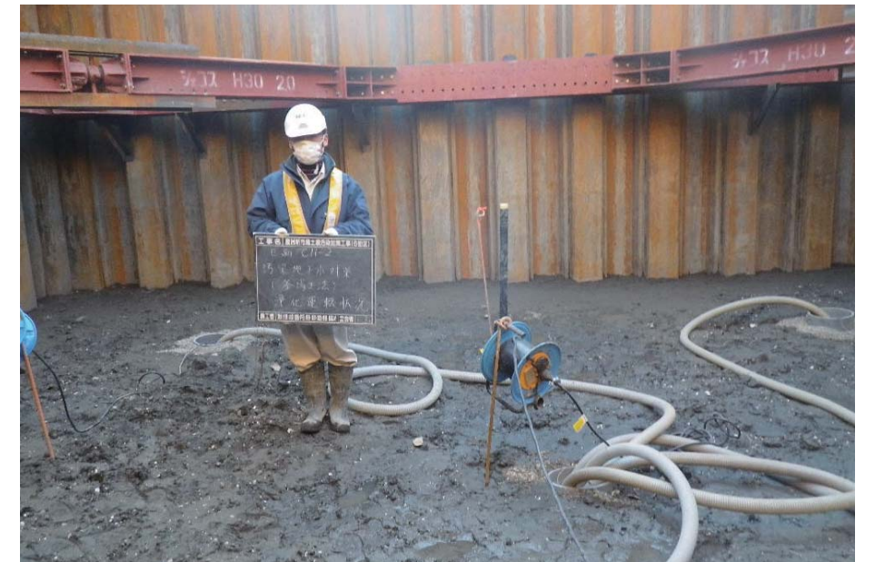
釜場運転状況
