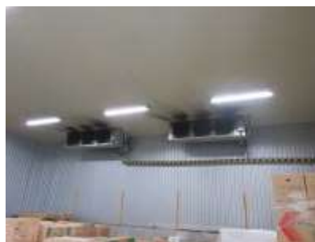
空調機・LED設置状況
