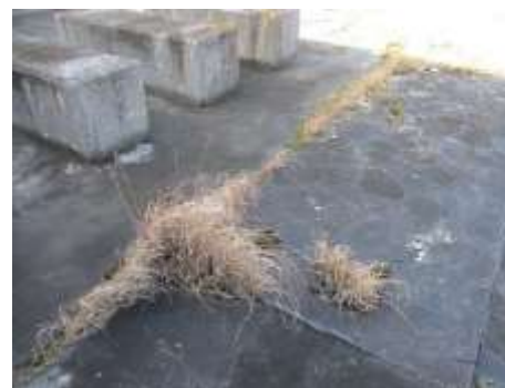
屋上（目地より雑草繁茂）
