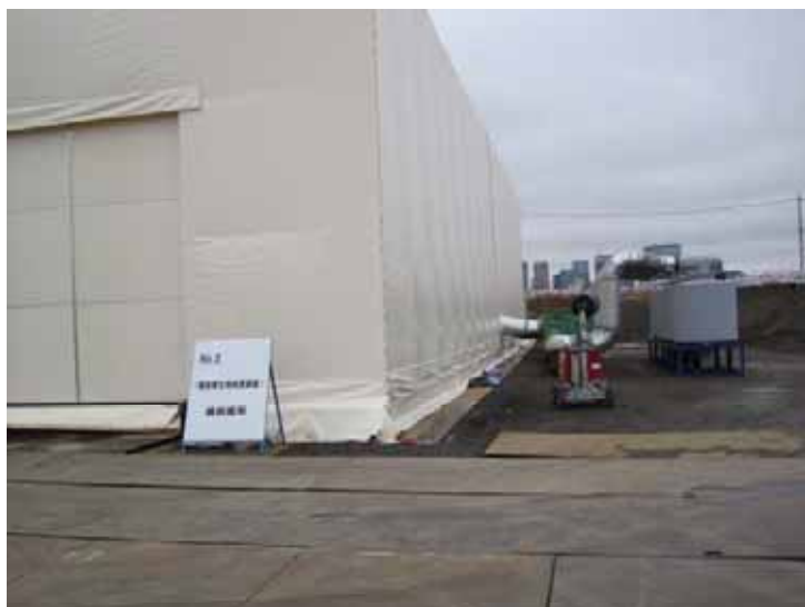
写真-5 換気装置と活性炭吸着装置
